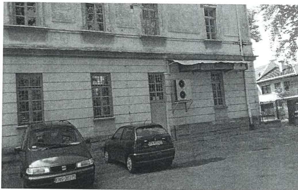
Zawilgocenie ściany, skorodowanie obróbek i zły stan zadaszenia.
