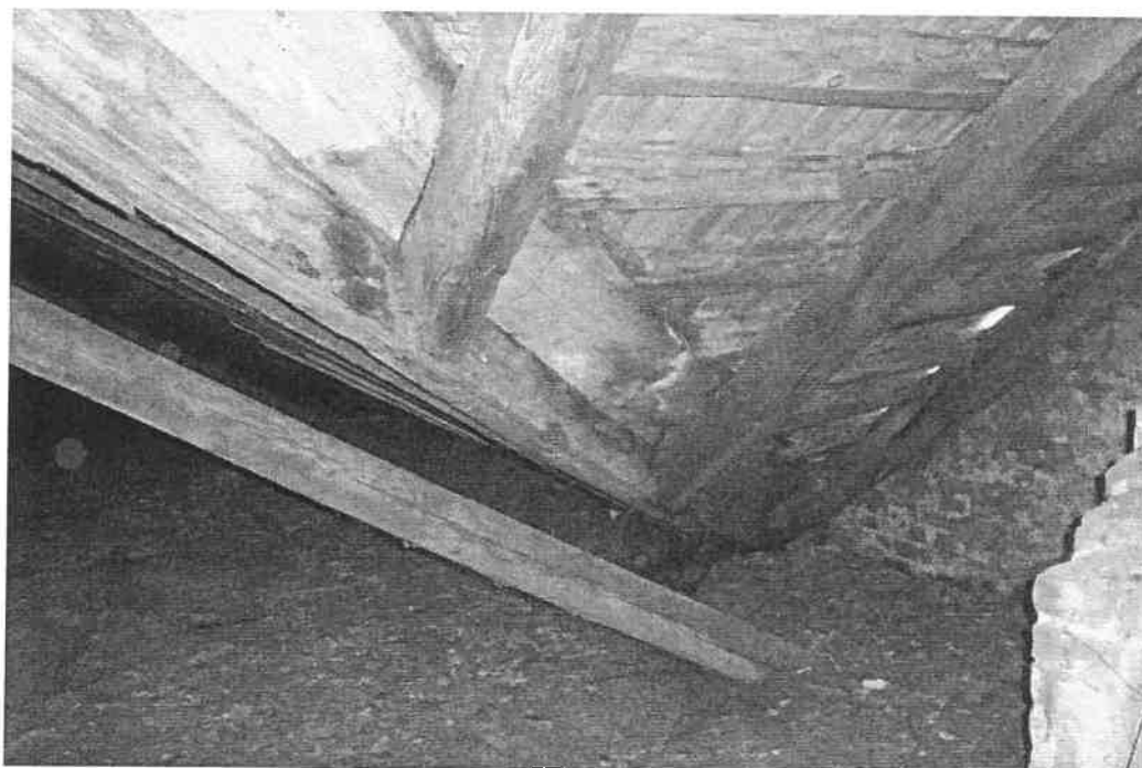
Zawilgocenie i białe naloty Grzyba na więźbie dachowej.
