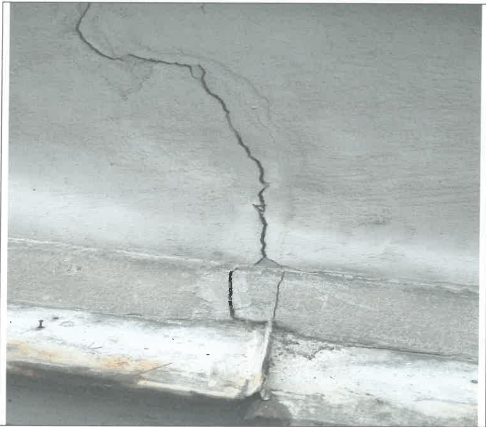
Fot nr 6 Uszkodzone nadproże okienne drugiego piętra
