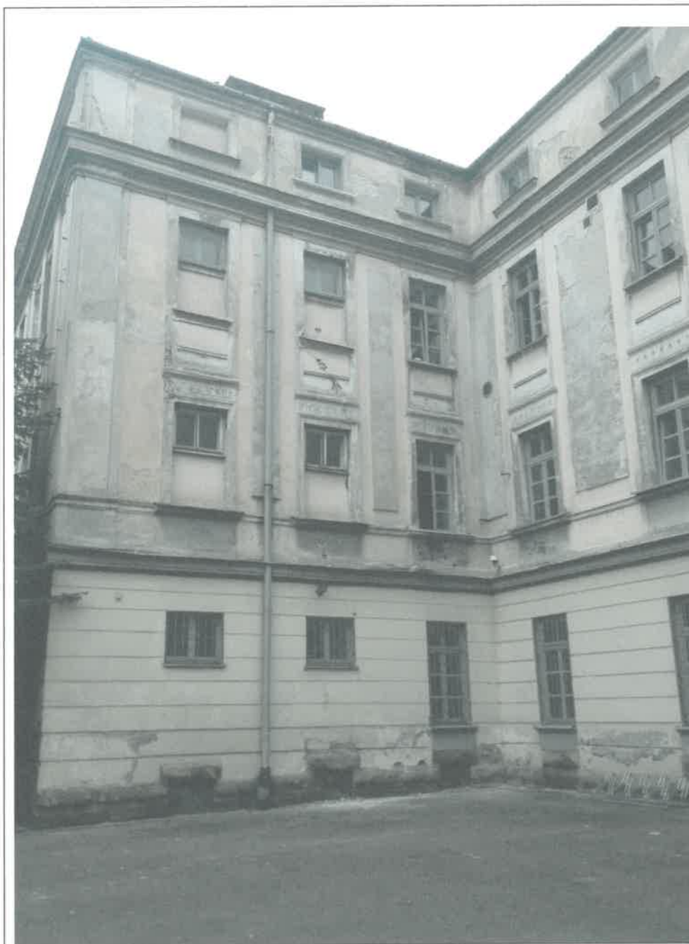
Fot nr 1 Widok ryzalitu od strony północnej – widoczne zarysowania i uszkodzenia ściany w środkowym pasie okien.
