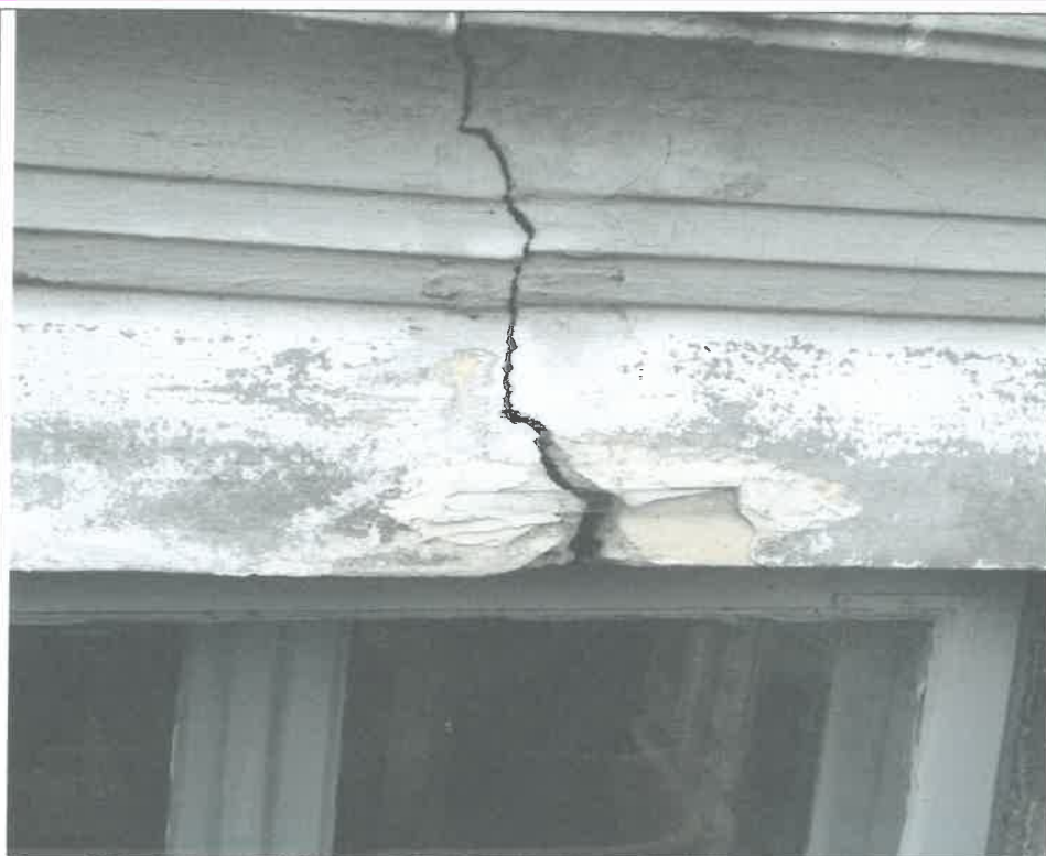
Fot nr 2 Uszkodzone nadproże okienne w poziomie II pietra- widoczna szybka kontrolna oraz przesunięcie płaszczyzny nadproża
