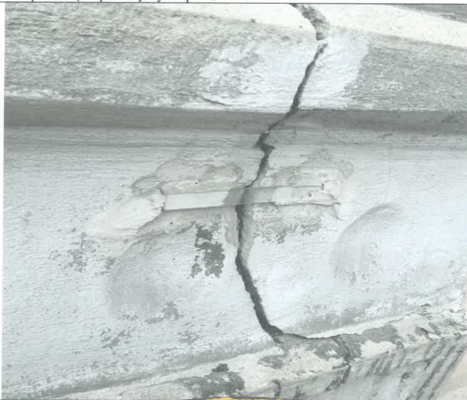
Fot nr 3 jw. nadproże okienne pierwszego piętra
