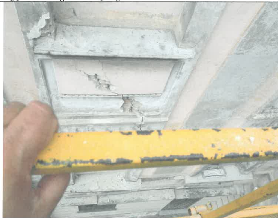
Fot nr 5 Uszkodzony pas muru podokiennika
