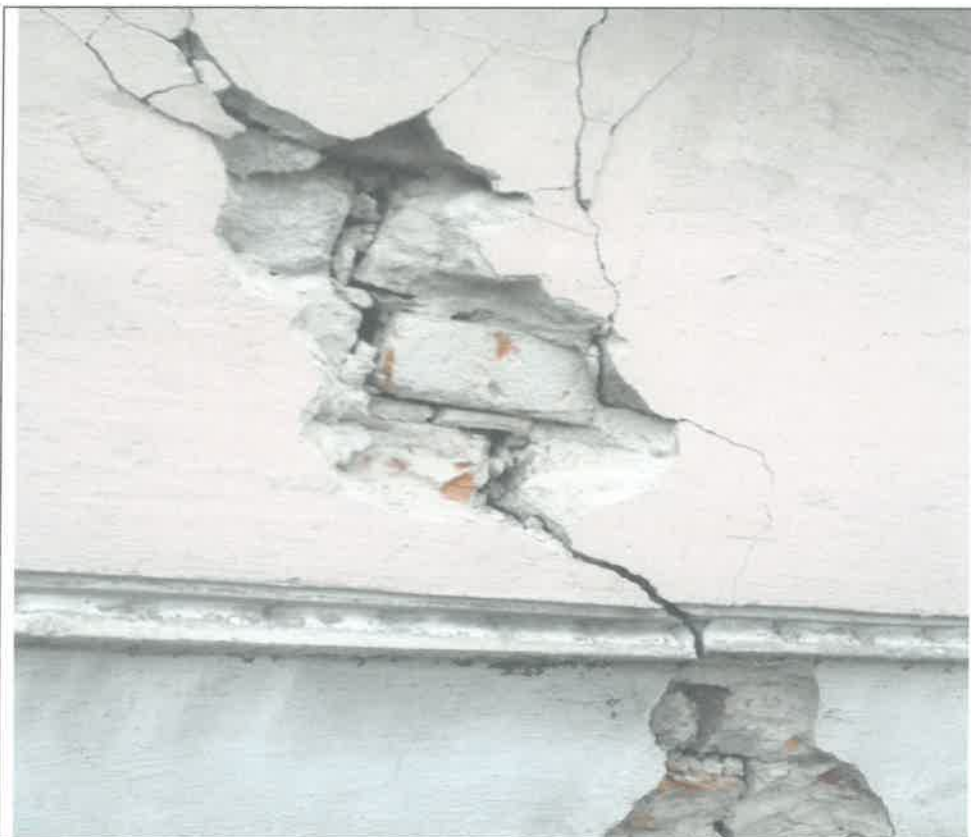
Fot nr 4 Pas muru pomiędzy oknami – wykonana odkrywka obrazuje brak przewiązań cegły w murze /cegła ułożona tylko główkowo/
